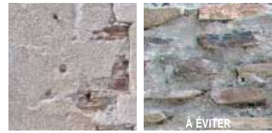
À ÉVITER Pierre jointée au ciment
